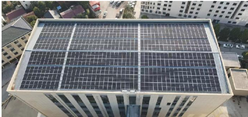
图13 卓远光伏项目
